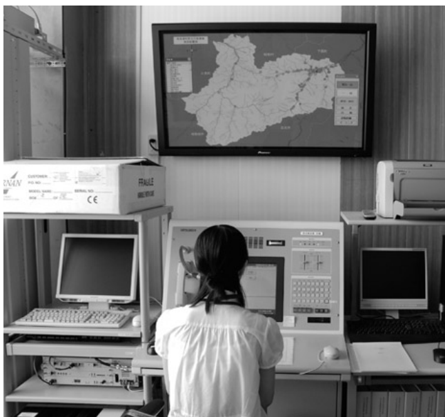
田島地域防災行政無線の放送設備
