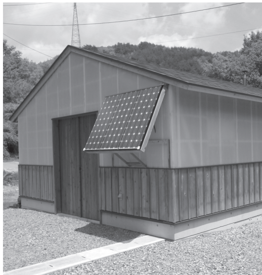
環境共生住宅（滝原地区）に設置された太陽光発電
